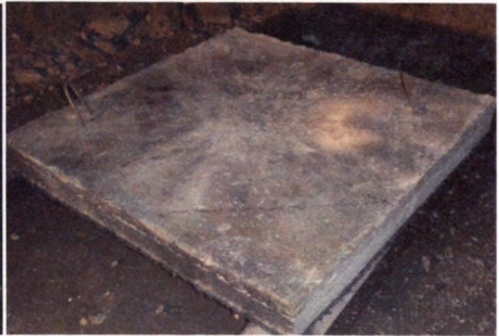
(d) Isometric View Cracks Outlined
