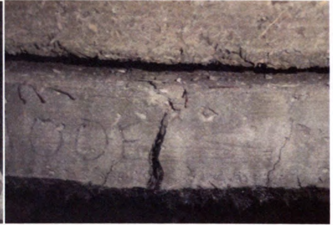
(d) Back Face Crack and Delamination
