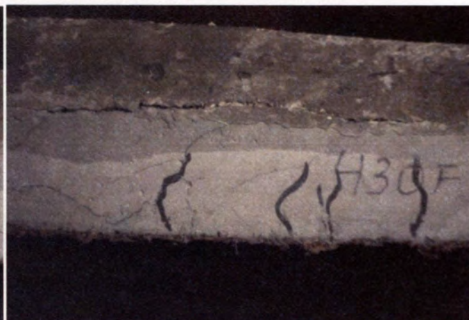
(d) Flexural Cracks in the Front Face
