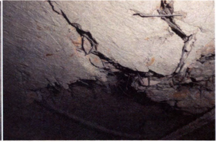
(d) Hole in the Tension Face
