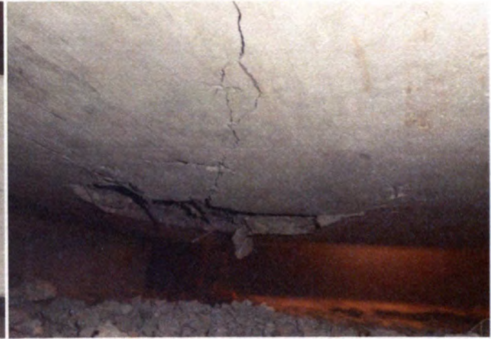
(d) Spalling on Tension Face
