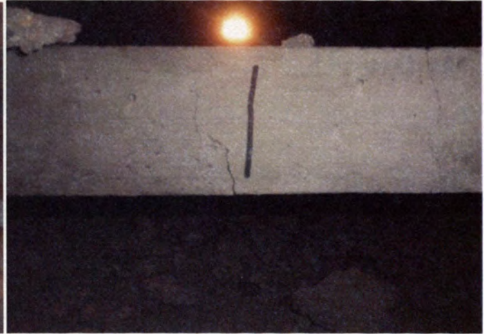
(d) Flexural Cracks in the Back Face
